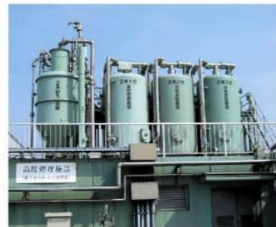
砂ろ過装置・活性炭吸着塔
